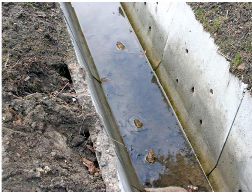
Fot. 10. Płazy uwięzione w rowie umocnionym przy pomocy korytek krakowskich
