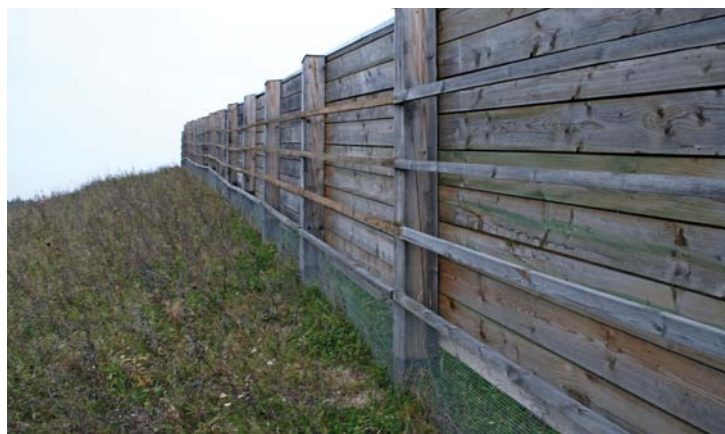
Fot. 15. Ekran wymagający dodatkowego zabezpieczenia siatką w dolnej części
