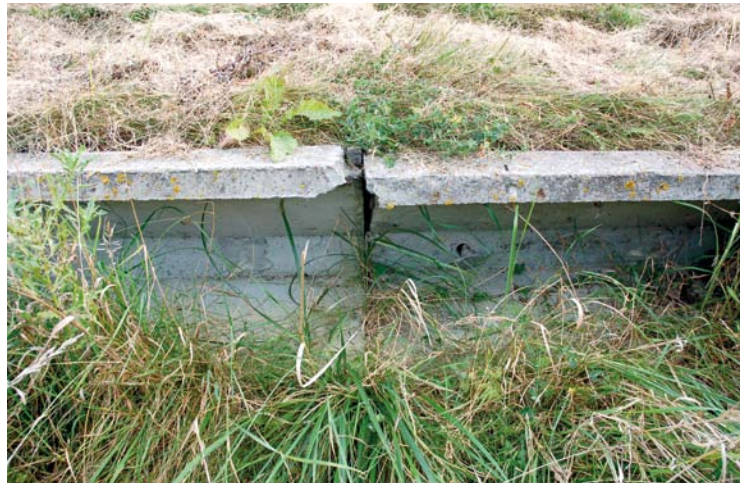
Fot. 41. Nieszczelności w ogrodzeniu betonowym powstałe w wyniku działania naporu gruntu oraz erozji wodnej
