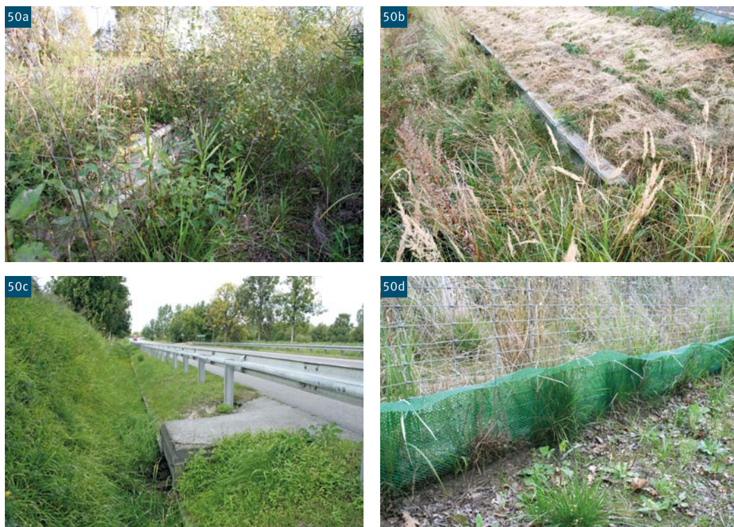
Fot. 50a, b, c, d. Ekspansja roślinności przy niewłaściwym utrzymaniu ogrodzeń (różnych typów)
