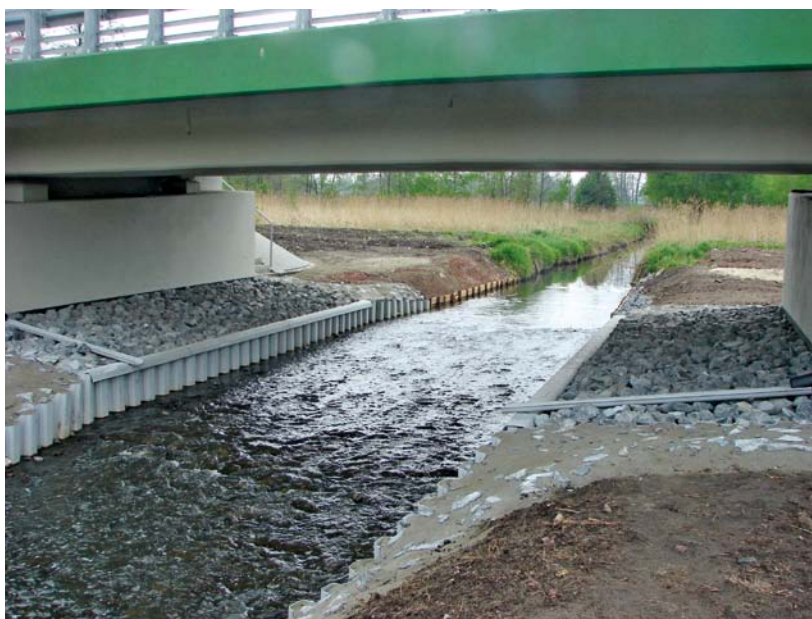
Fot. 5. Niewłaściwe umocnienia cieków utrudniają przemieszczanie się płazów w poprzek i wzdłuż koryt
