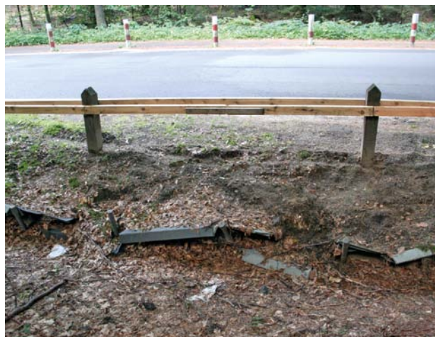
Fot. 61. Ogrodzenia prefabrykowane z płyt polimerowych także ulegają uszkodzeniom wymagającym napraw
