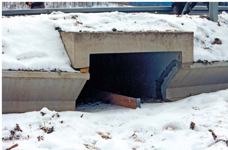
Fot. 65. Przejście dla płazów o przekroju prostokątnym połączone z ogrodzeniem ochronno-naprowadzającym
