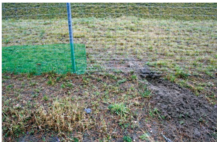
Fot. 35. Podkop pod zbyt krótkim ogrodzeniem
