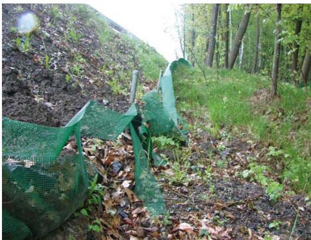
Fot. 60. Efekt braku kontroli i napraw ogrodzenia na placu budowy
