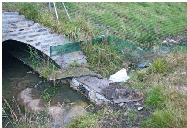
Fot. 92. Półki wykonane z gabionów często sprawiają problemy w zakresie właściwego i trwałego wykończenia ich powierzchni
