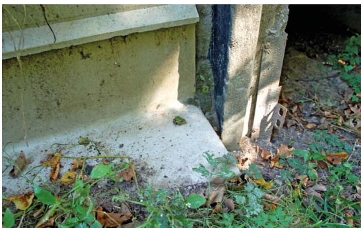
Fot. 45. Ogrodzenia z pełnych płyt sprawiają często problemy przy połączeniach z przejściami jeśli nie są to obiekty wykonane z dedykowanych prefabrykatów
