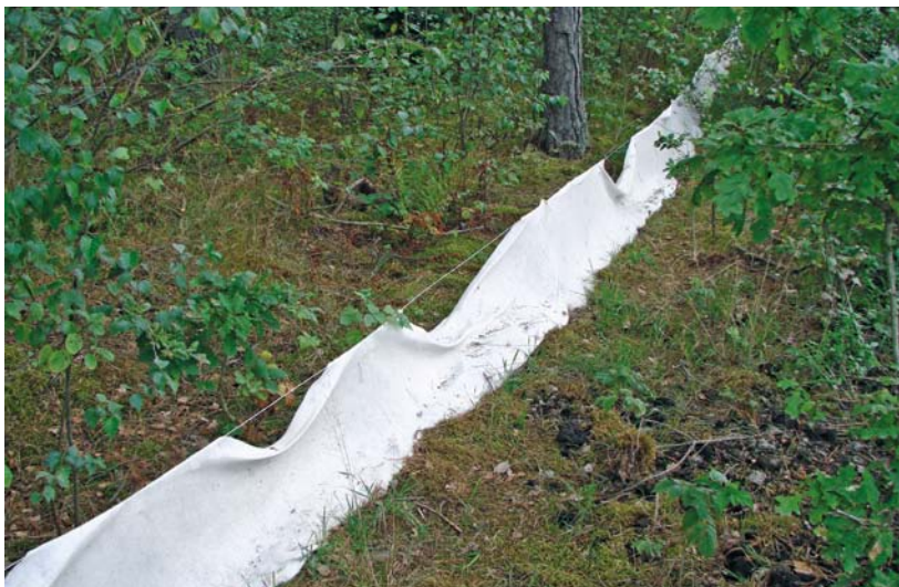
Fot. 109. Niewłaściwie wykonane ogrodzenie z geowłókniny – materiał pod wpływem deszczu rozciąga się, tworząc liczne nieszczelności
