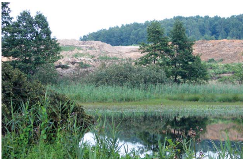
Fot. 107. Budowa drogi na obszarach podmokłych powoduje ogromne zniszczenia w siedliskach płazów, m.in. z powodu przemieszczania i składowania zbędnych mas ziemnych
