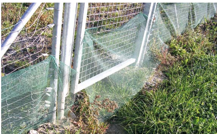
Fot. 49. Ogrodzenie z siatki polimerowej niedbale połączone z ogrodzeniem dla dużych zwierząt
