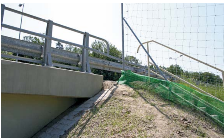
Fot. 44. Nieszczelne połączenie ogrodzenia dla płazów z małym mostem
